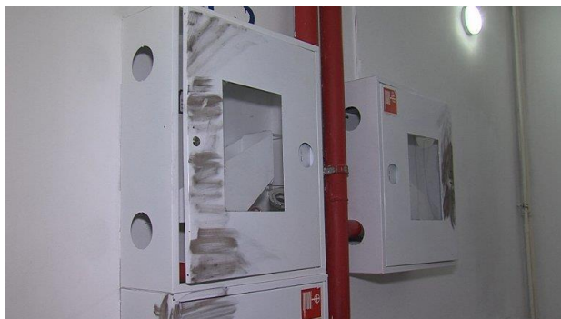
Рис. 1. Состояние пожарных шкафов в многоэтажке
