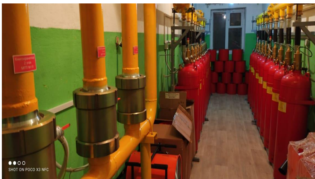
Рис. 2. Модули в составе установки
