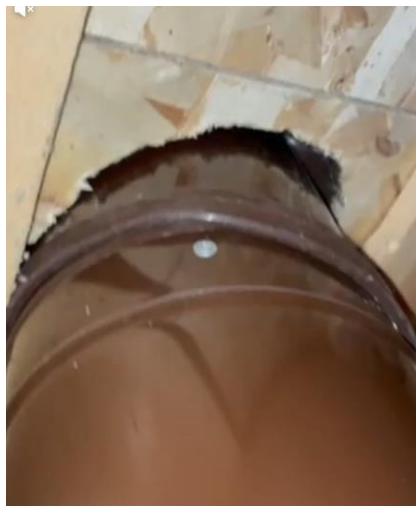
Рисунок. Нарушения при монтаже дымохода по типу «сэндвич трубы»
