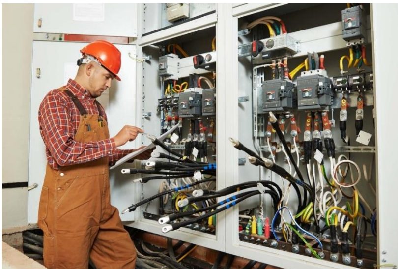
Рис. 5. Пример правильного использования электрического оборудования
