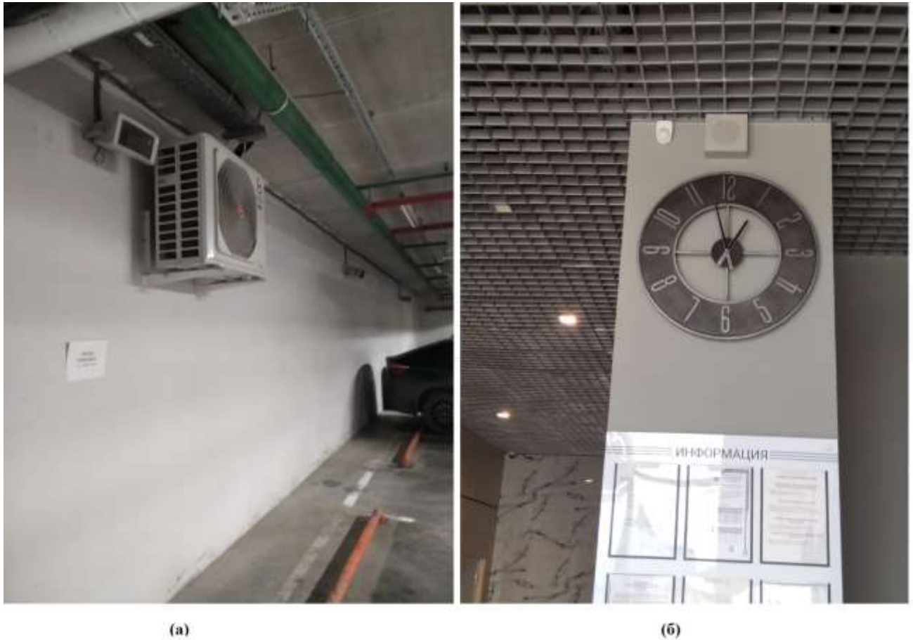
Рисунок П5.2 – а) речевой оповещатель ROXTON MP-30T, расположенный на парковке минус первого этажа; б) речевой оповещатель ROXTON WS-06T, расположенный на посту охраны первого этажа
